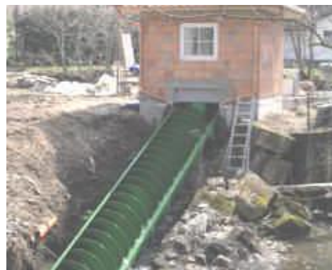
5 kW System, Sachsenflur, Germany
